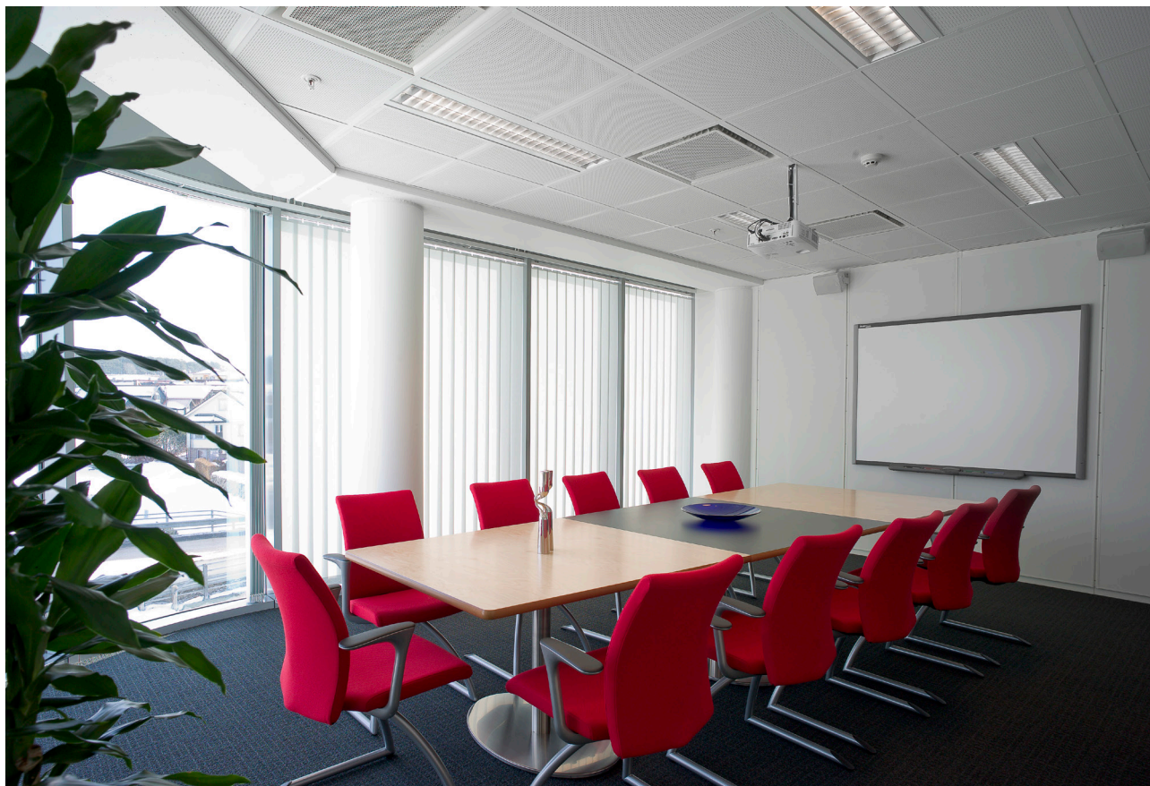
Bild 3. Mötesrum, aktiva Plexus-kylbafflar med separat reglerad belysning.
