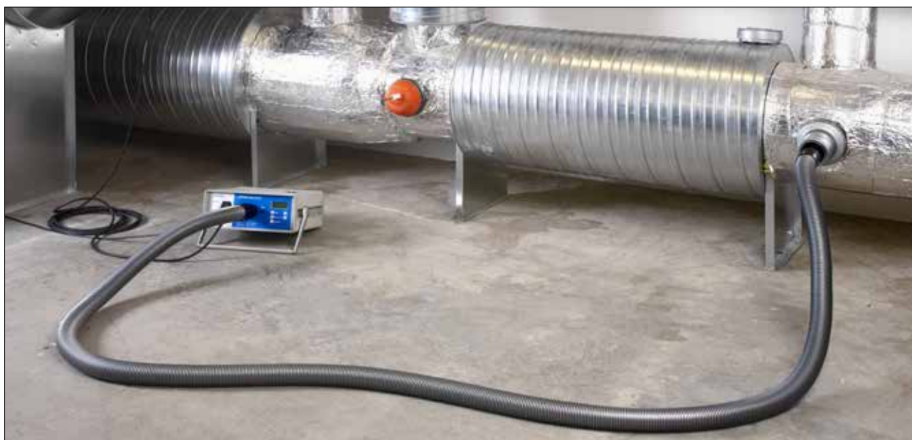
Bild 3: Anslutning till kanalsystemet
